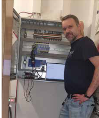
Foto: RW Technischer Gebäudeservice
